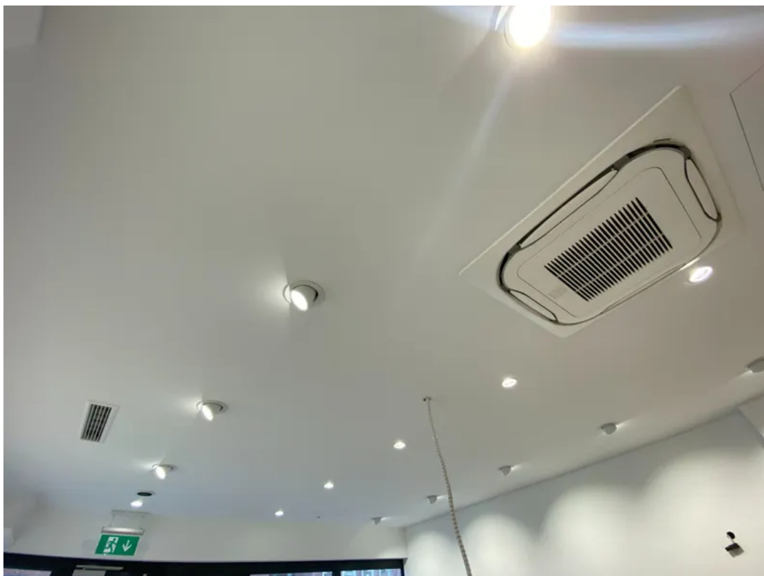
LED leuchten und Klimaanlage
